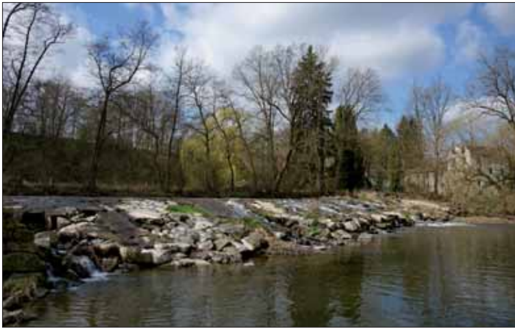
Abb. 1: Das Wehr der Abtsmühle am Pram-Unterlauf bei Schärding ist bereits um das Jahr 1200 belegt.
